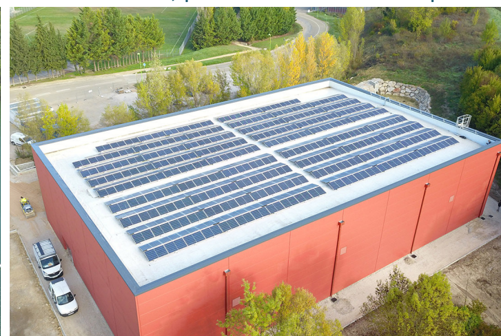
Panneaux photovoltaïques, Halle des Sports de St Martin de Londres - K-helios
