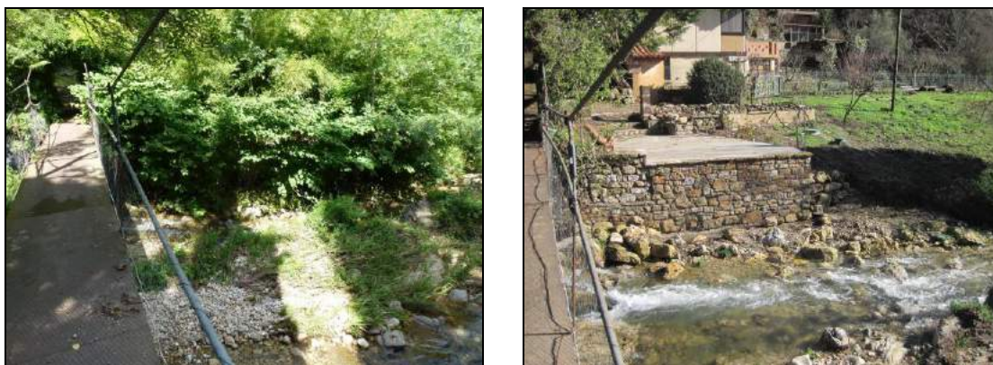
Avant et après travaux d'élimination d'un massif de Renouée sur les berges du Laurounet (CC Lodévois et Larzac)
