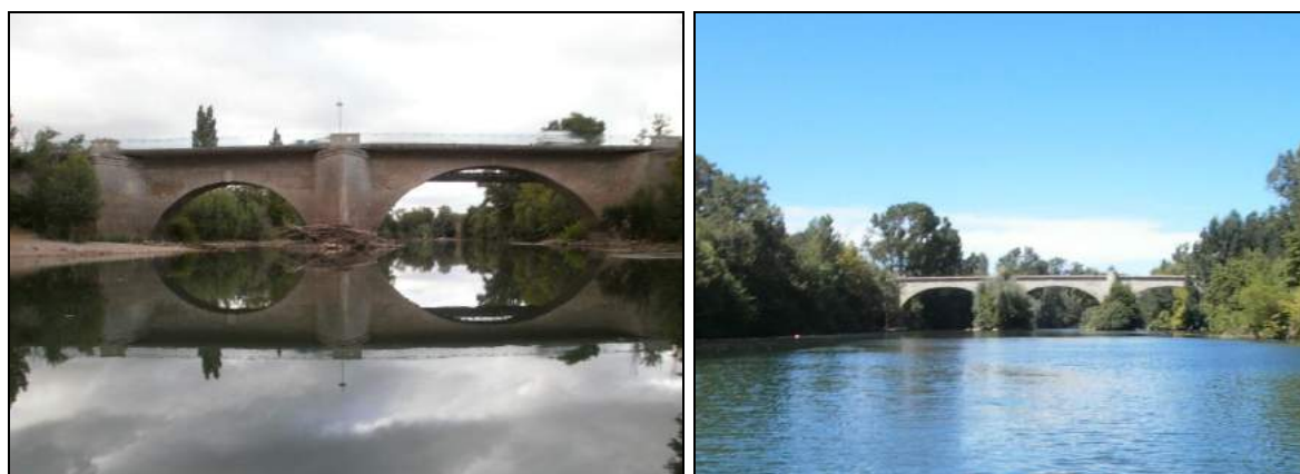
Ponts vulnérables aux embâcles
